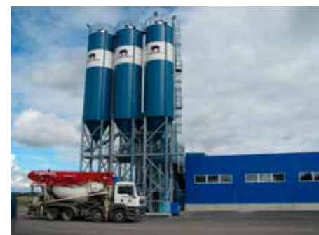
TMB grupi betoonitehas Vahi Tööstuspargis Tartumaal, 2013. The TMB Group Concrete Factory in Vahi Tööstuspark in Tartu County, 2013.
